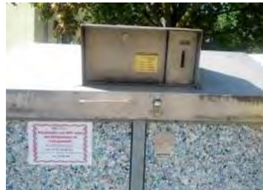
Slika 7: Primer zabojnika z zapiralom in sistemom identifikacije v stanovanjski soseski "Elbtal" Heidenau, Nemčija (foto: S. Guerrero Mercado)
